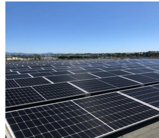
Planta fotovoltaica en cubierta
